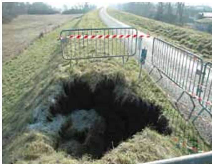
▲ Fontis, dû à la présence d'un système karstique en profondeur, survenu au sommet de la digue au niveau de la commune de Jargeau (Loiret).
