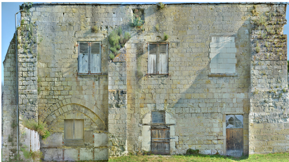
Fig. 15 - Marmoutier, face sud de la partie conservée en élévation du bâtiment 2 (orthophotographie LAT).
