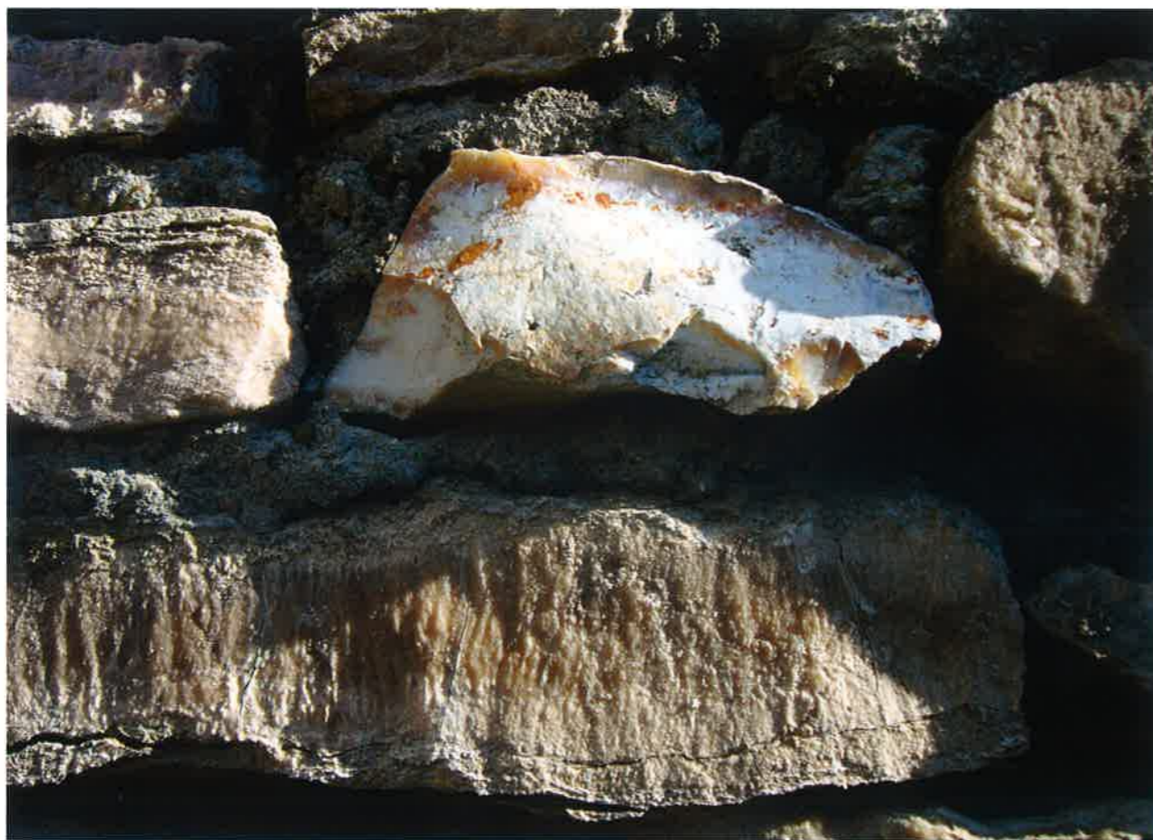
Fig. 1 – I Crivellari (Riolo Terme): particolare del muro di un vecchio edificio in blocchi di gessarenite e selce locale (foto M. Sami).
