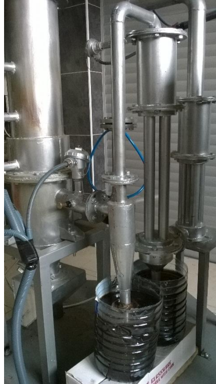
Şekil 3.5. Gaz temizleme sistemi
