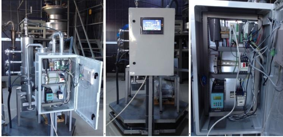
Şekil 3. Sistemde kullanılan ölçüm ve kontrol sistemi
