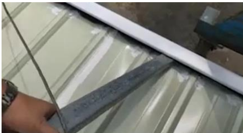
Figura I.20. Deformación de los bordes de la chapa metálica (JJC Houses, 2019)
