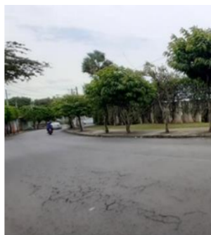
Imagen 60: Calle con fisuras. Fuente: Villalobos, J., Torres, L. & Castillo, A. (2021)
