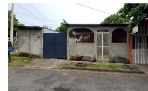
Imagen 33: Vivienda en mal estado ETAPA 1 Fuente: Villalobos, J., Torres, L. & Castillo, A. (2021)
