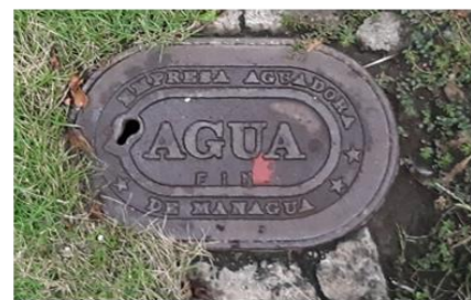
Imagen 41: Medidor de Agua Potable Fuente: Villalobos, J., Torres, L. & Castillo, A. (2021)
