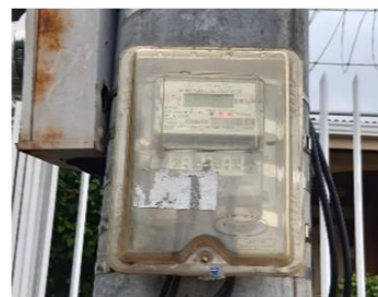
Imagen 42: Medidor de Energía Eléctrica Fuente: Villalobos, J., Torres, L. & Castillo, A. (2021)
