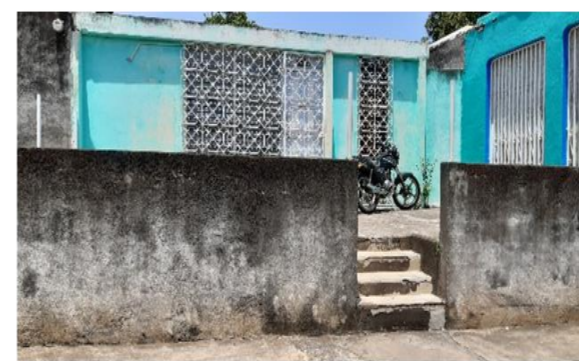
Imagen 30: Vivienda en mal estado ETAPA 1 Fuente: Villalobos, J., Torres, L. & Castillo, A. (2021)
