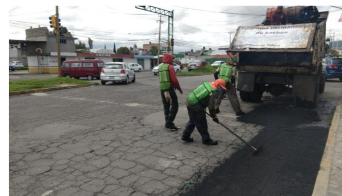
Imagen 397: Ejemplo de Bacheo. Fuente: Diario El Portal, S.F
