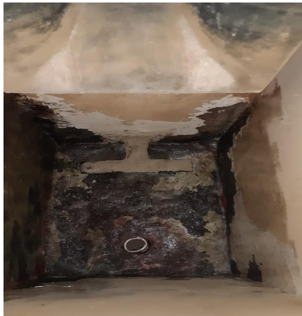
Figura 15: Parte inferior y costado del tanque en mal estado.
