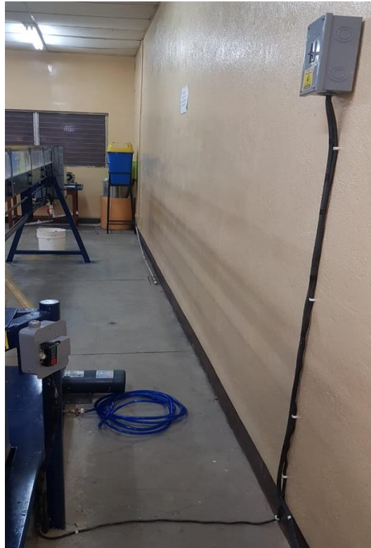
Figura 46: Sistema eléctrico del canal hidráulico.
