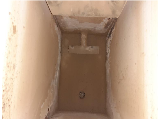
Figura 14: Estado en que se encontró este tanque.
