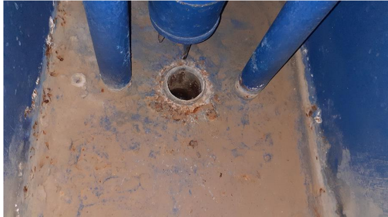
Figura 17: Ducto de descarga principal, anillo de cuello en mal estado.
