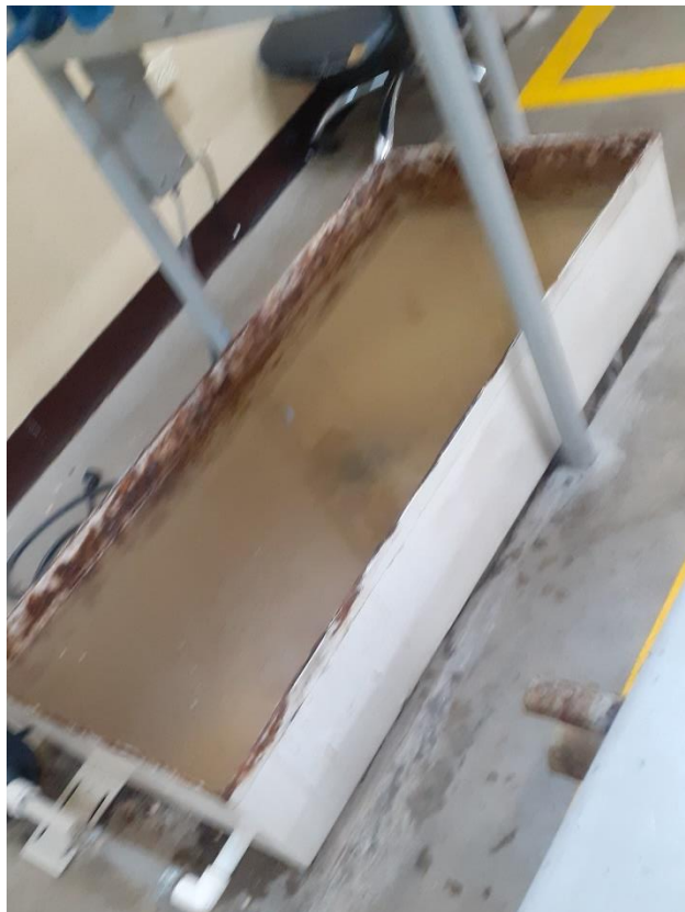
figura 13. Estado en el que se encontró el tanque cisterna.
