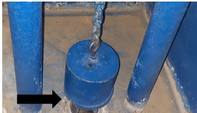
Figura 18: Empaque de retención de agua, en mal estado.
