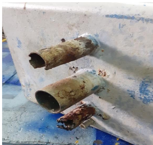
Figura 19: Ductos auxiliares de descarga.
