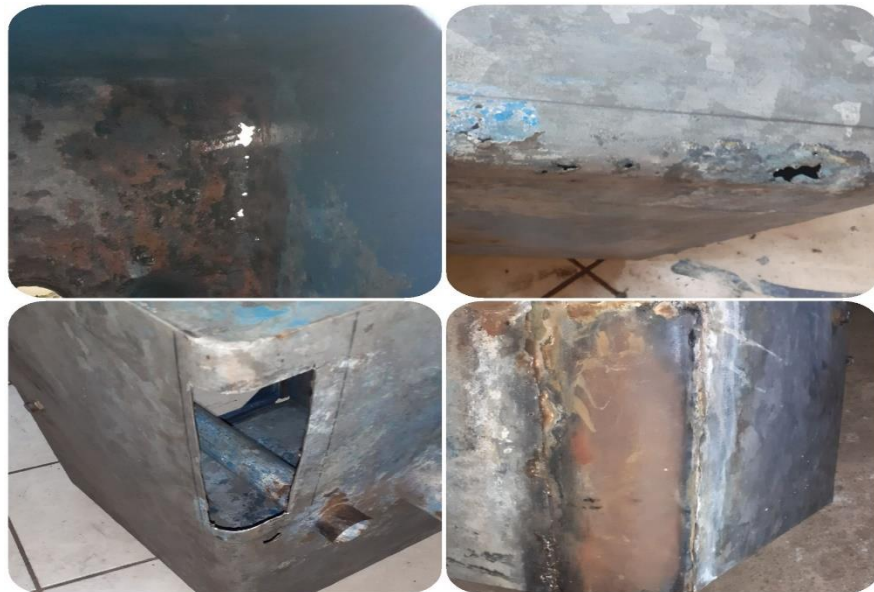
Figura 33: Avería encontrada en el tanque pesador.
