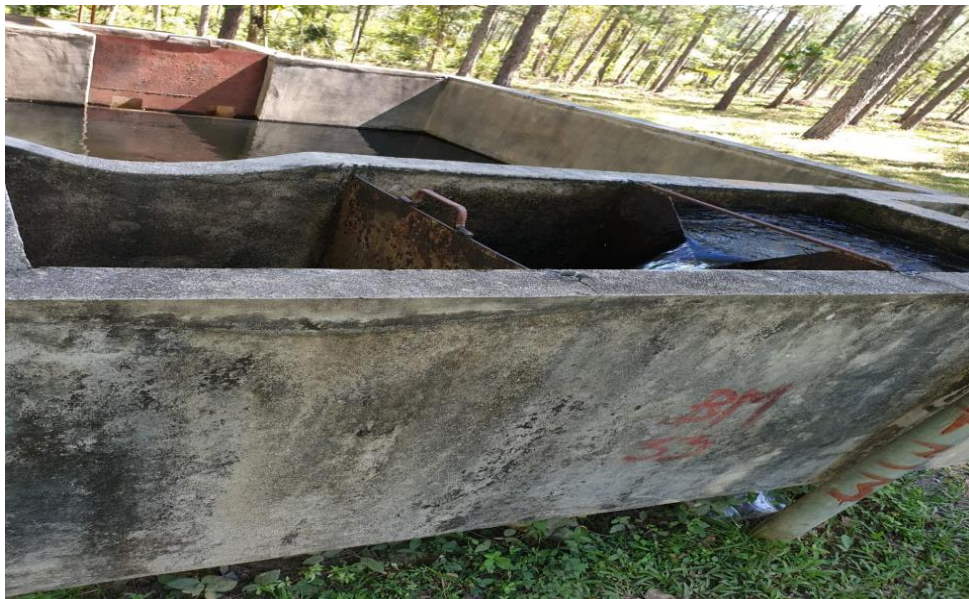
Ilustración 10. Tratamiento actual del agua potable
