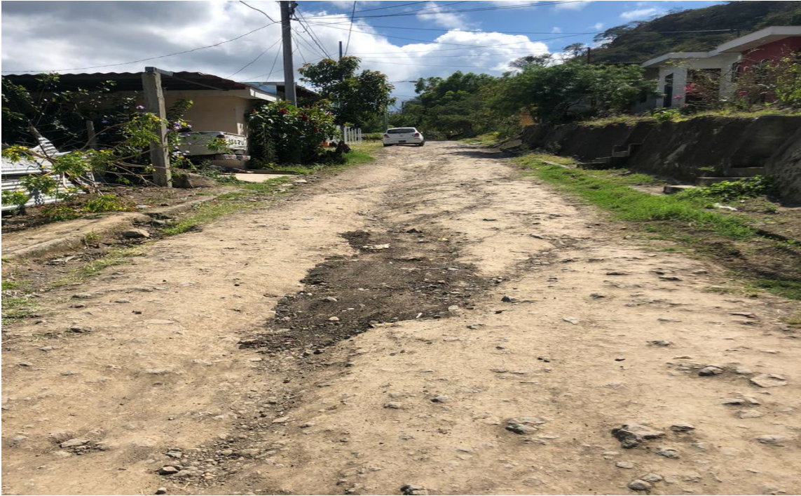
Fotografía 3: Baches rellenados por los habitantes (Tercera calle)
