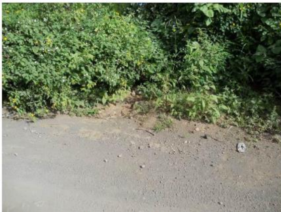
Pm2 y pm3. Puntos vulnerables a erosión hídrica. Rasante actual de camino constituida por material vulnerable a erosión. Revestir camino y dotar de obras de
