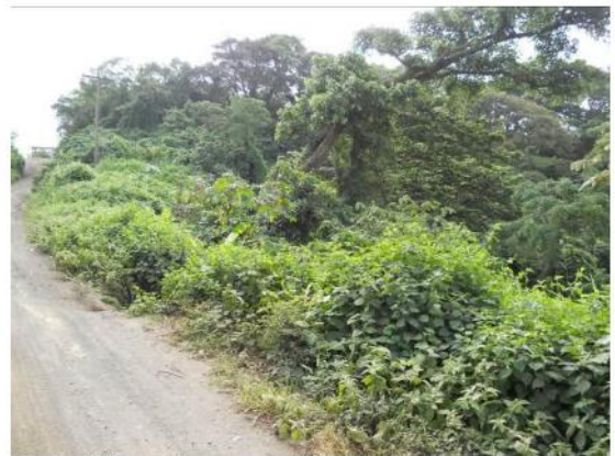
Pm1. Vulnerable a erosión hídrica a ambos lados. Sustrato arenoso. Construir sistema de contención para ampliar sección de carretera
