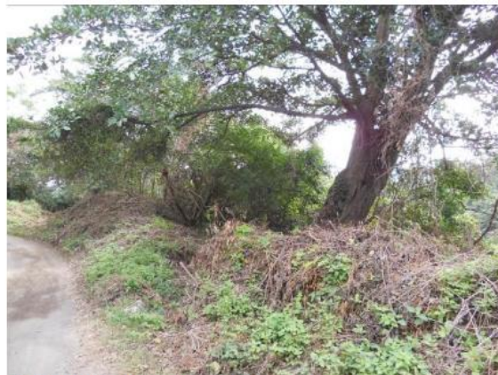
Pm4. Evidencia de deslizamiento superficial, punto relativamente estable. Vulnerabilidad por inestabilidad del sustrato. Remover capa inestable.
