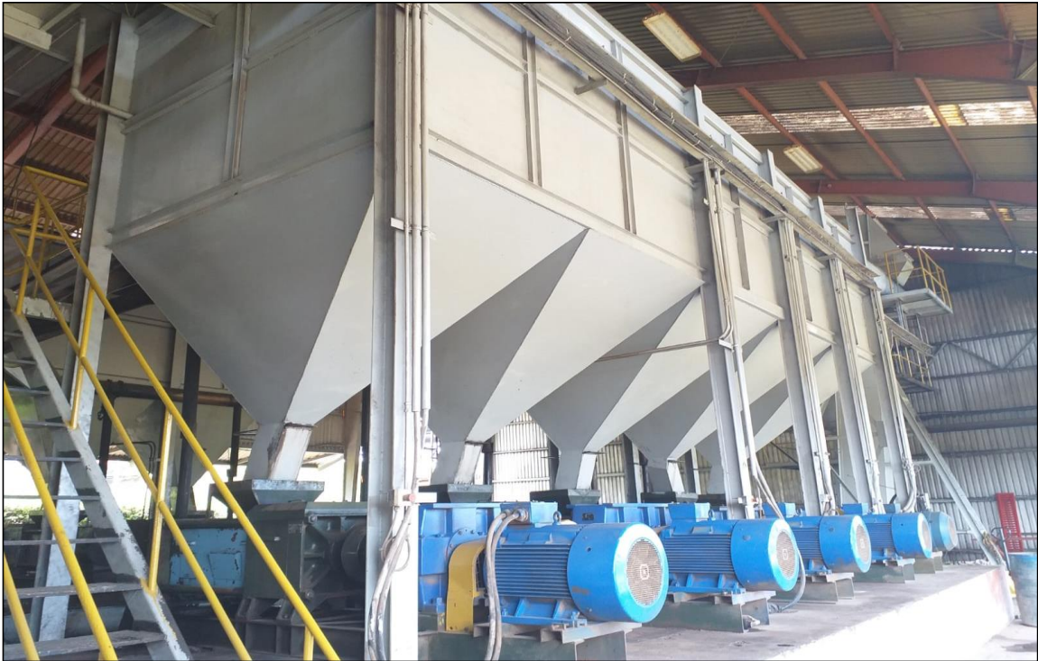
Ilustración 35 Tolvas y prensas primer etapa
