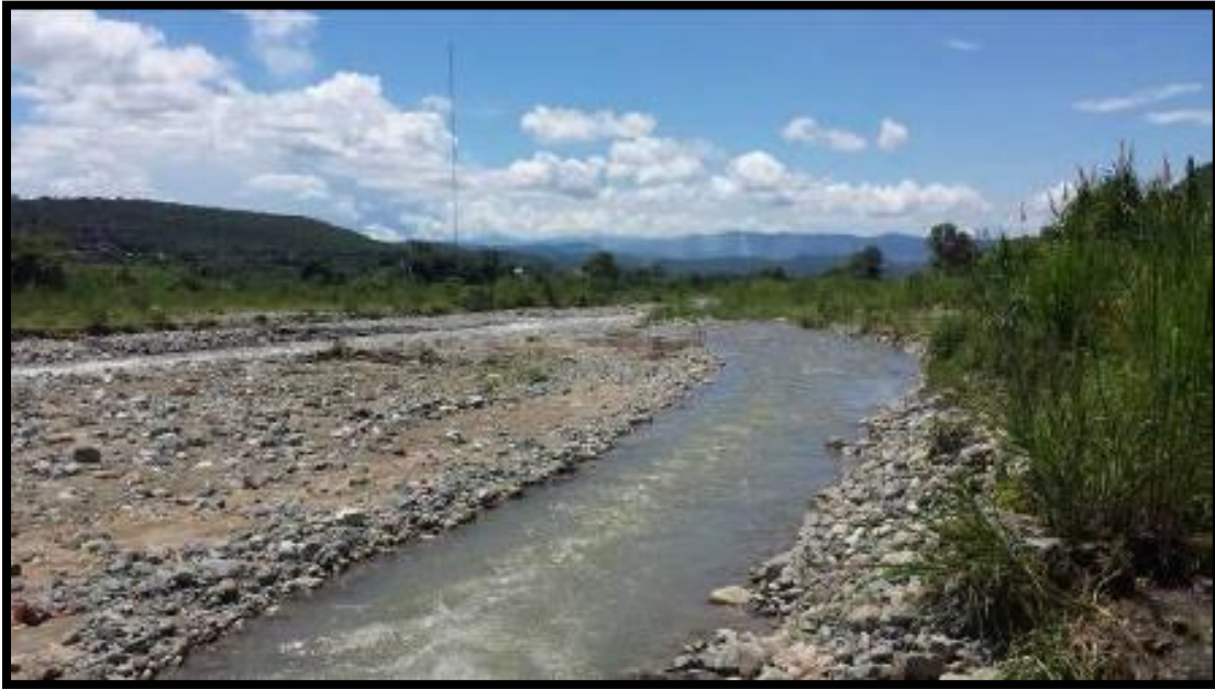
Figura 4: Tramo del Km 09+010 al Km 09+160: (Margen derecha del Río Amojú) se observa suelos granulares en la ribera del río.
