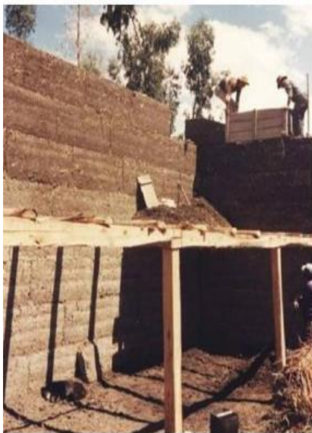
Figura 95: Construcción de Muro de Tapial, San Bartolomé. Fuentes: Uso del Tapial en la Construcción, Sencico 2016
