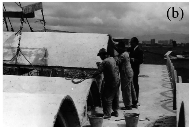
Figura 12. (a) Izado de las membranas de hormigón en la fábrica de jabón, Bogotá, 1954; (b) Posicionado de las membranas con ayuda de dos operarios y la participación de Álvaro Ortega. (Fuente: Fondo CINVA, Archivo Histórico de la Universidad Nacional de Colombia, caja 175).
