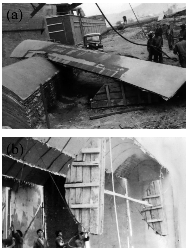
Figura 13. (a) Desprendimiento de una de las membranas construidas para la fábrica de jabón, Bogotá, 1954; (b) Aparejo provisional en madera situado por el intradós de la membrana para darle mayor rigidez durante el proceso de posicionado. (Fuente: Fondo CINVA, Archivo Histórico de la Universidad Nacional de Colombia, caja 175).
