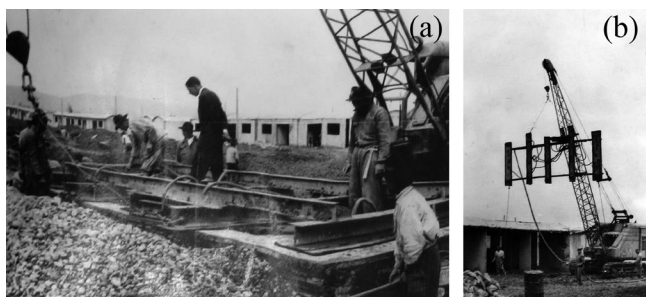
Figura 4. (a) Construcción de muros prefabricados a nivel de piso mediante la técnica del hormigón al vacío; (b) Elevador de vacío empleado en Bogotá, 1950. (Fuente: Fondo CINVA, Archivo Histórico de la Universidad Nacional de Colombia, caja 175).
