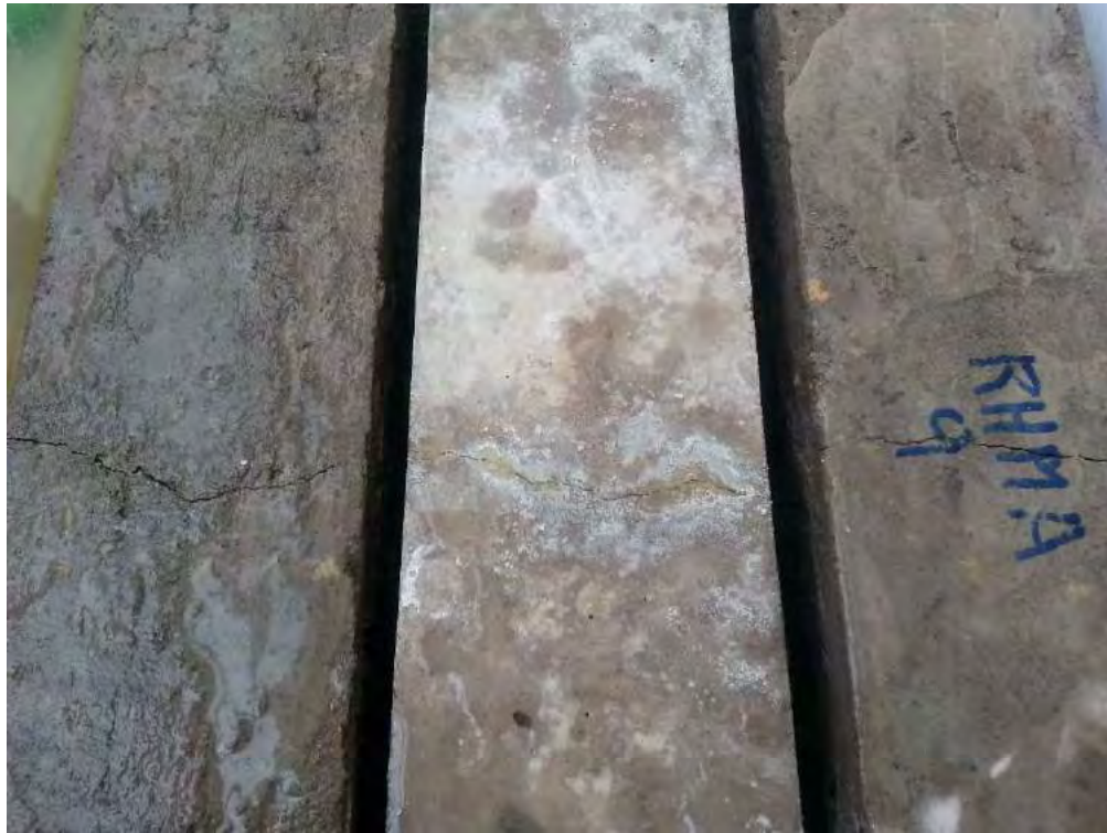
Figura 87. Prismas de concreto fisurado (antes de la curación a base de bacterias)
