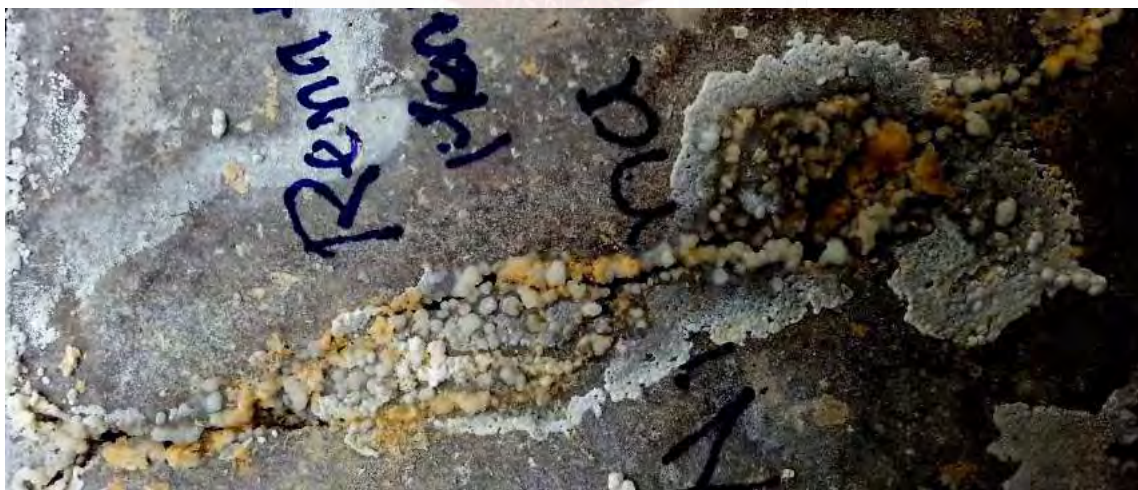
Figura 119. Proceso de autocuración de fisura de concreto.
