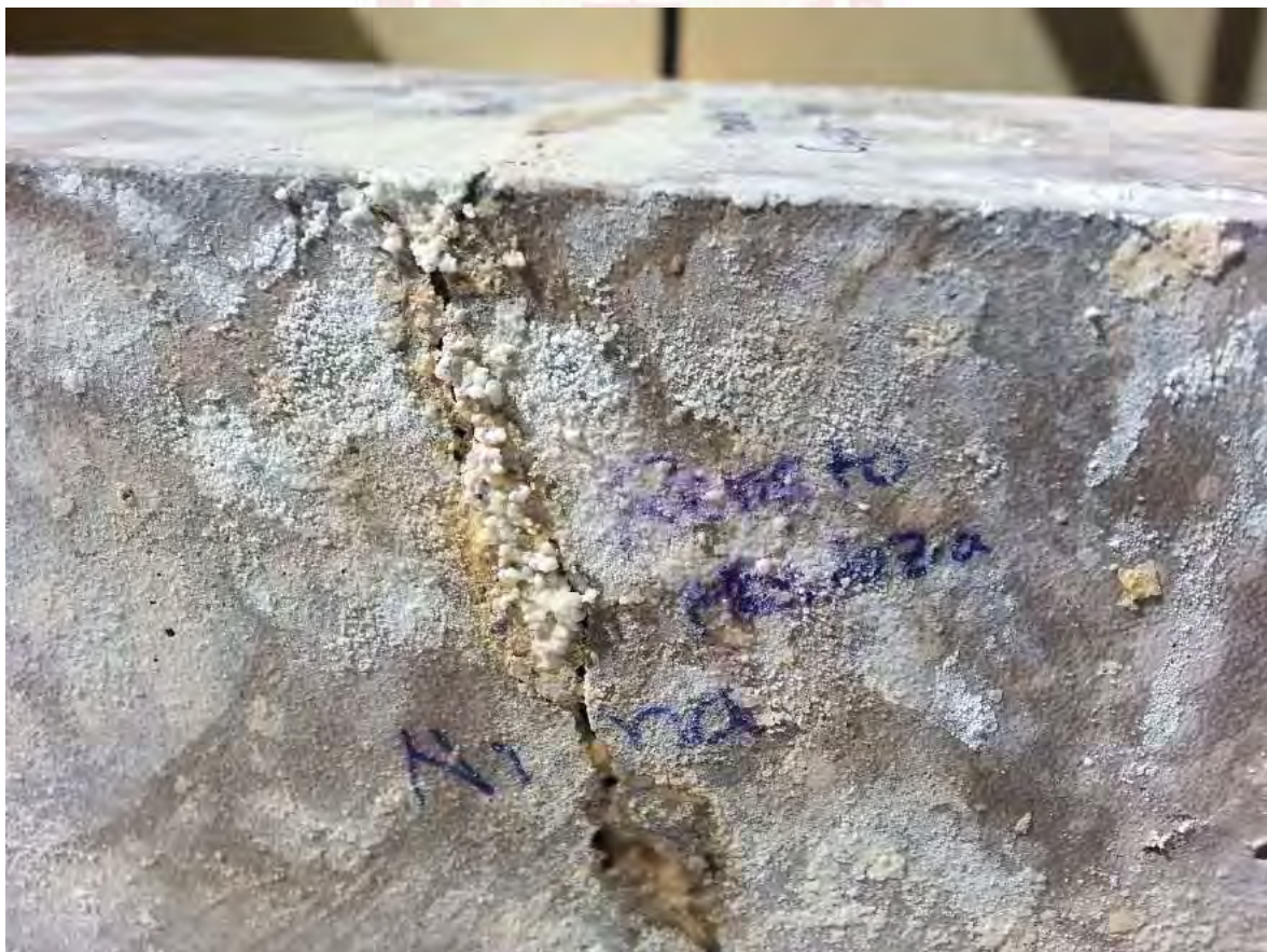
Figura 109. Fisura de concreto reparado con \text{CaCO}_3 a base de bacterias a los 47 días.
