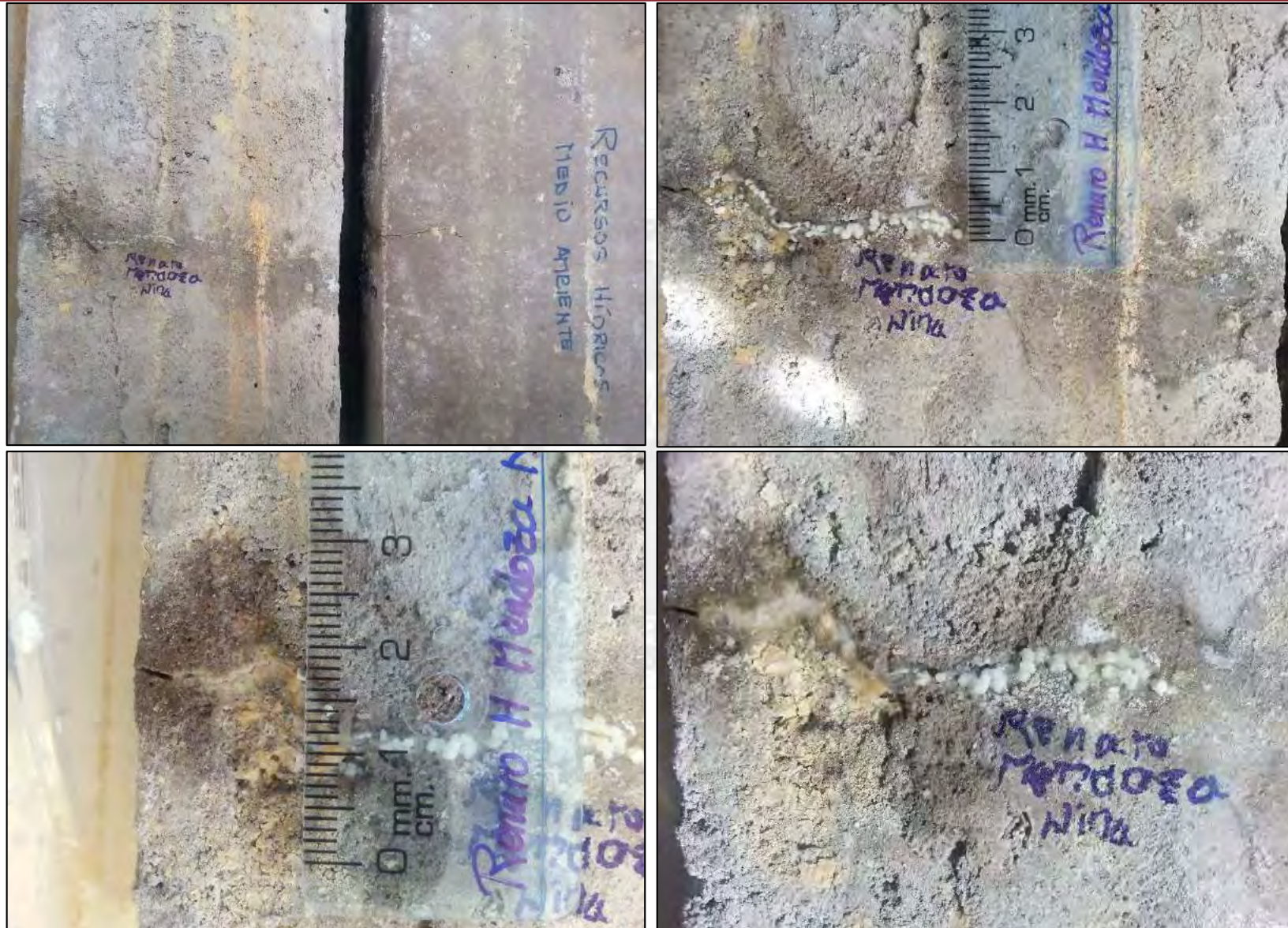
Figura 94. Formación de \text{CaCO}_3 en las fisuras de concreto.
