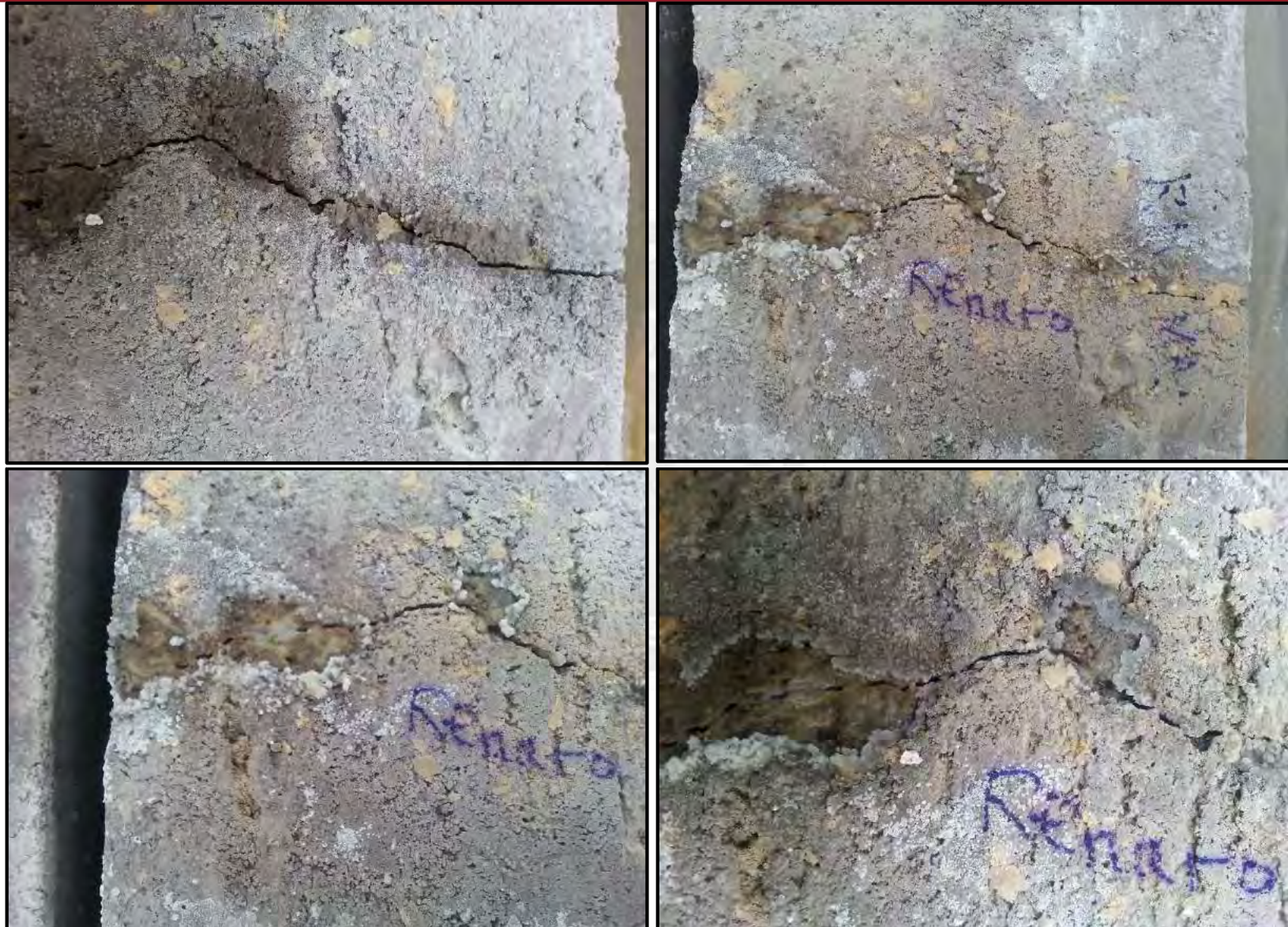
Figura 93. Bioprecipitación de fisuras en prismas de concreto.
