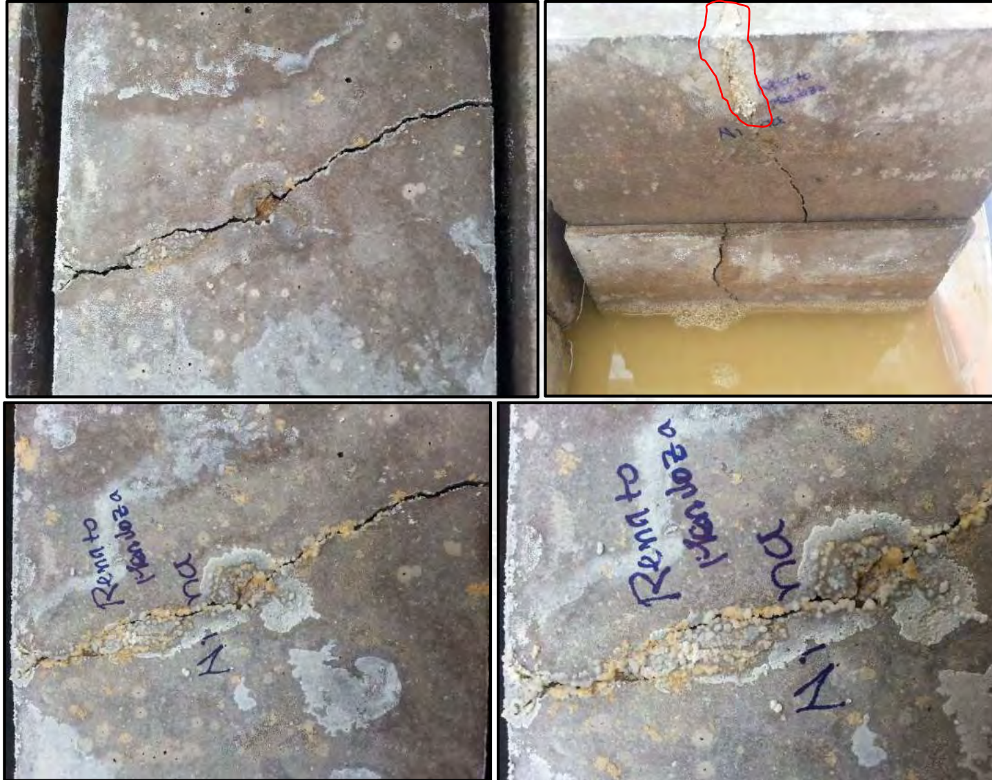
Figura 91. Precipitación de carbonato de calcio en fisuras de concreto.
