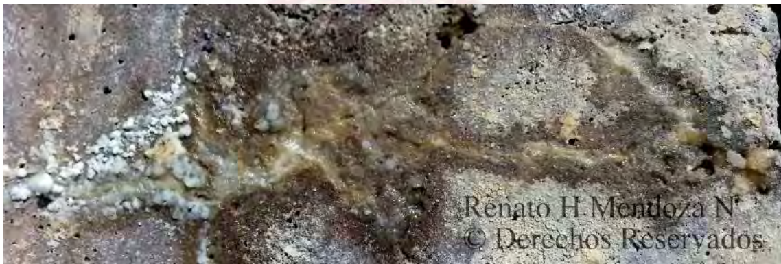
Figura 117. Auto-curado de fisuras de concreto a base de bacterias después de 86 días.
