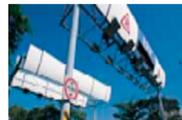
Cámaras de Detección
