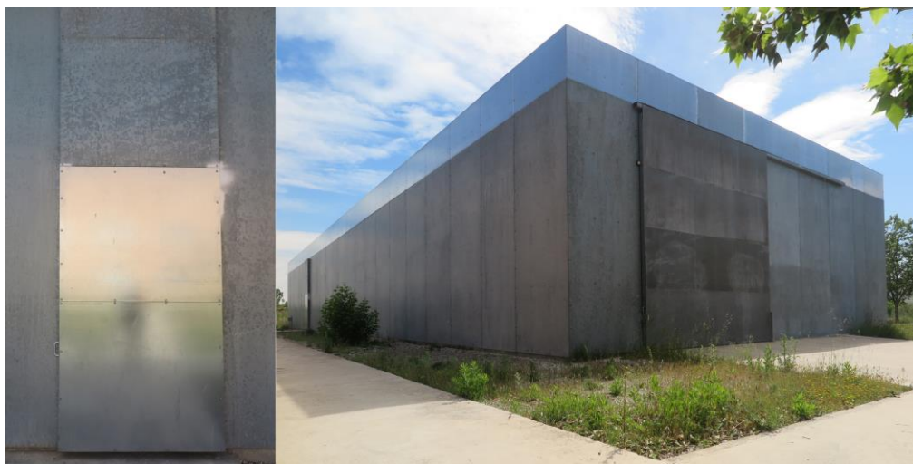
Fig. 7. Almacén de Gases y residuos, 2009. Estado actual. Fuente: imagen elaboración propia.
