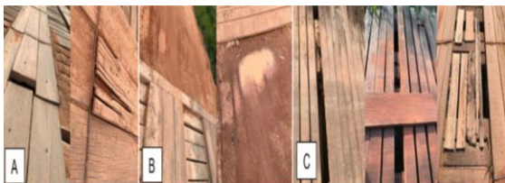
Figura 168. (A) Tábuas do rodeiro com empenamento (B) Aterro de acesso das pontes abaixo do tabuleiro (C) Ausências de peças de madeira.
