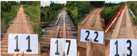
Figura 104. Pontes 11, 17 e 22 com ausência de barreira rígida e ponte 13 com destaque para a barreira rígida em sua composição estrutural.
