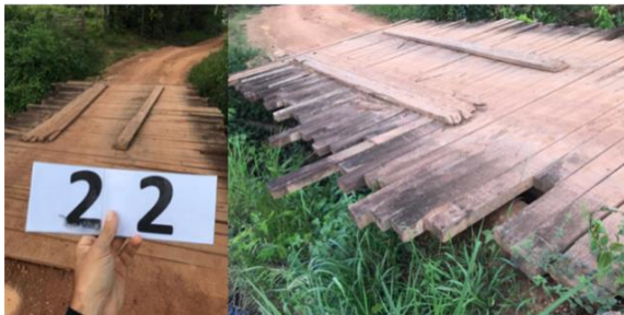
Figura 7.1 Ponte construída por moradores, devido à queda da ponte principal.
