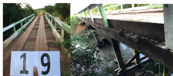
Figura 5. Ponte que apresentou maior vão das obras analisadas e reforço no travamento dos pilares.
