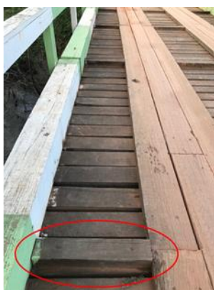
Figura 13. Peças do rodeiro da ponte 19 travadas por pregos e peças de madeira.
