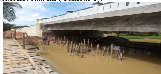
Gambar 1 Kondisi Jembatan Sei. Lukut di Kecamatan Rumbai
