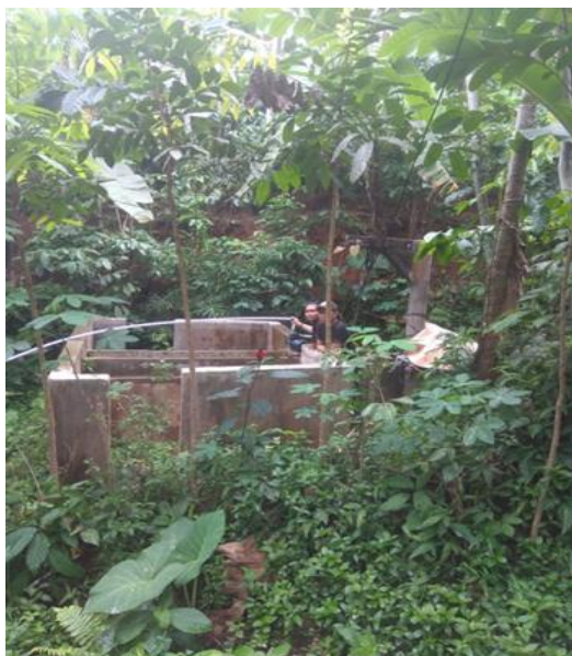
Gambar 3 dokumentasi instalasi penyiraman sudah terpasang di lahan kopi
