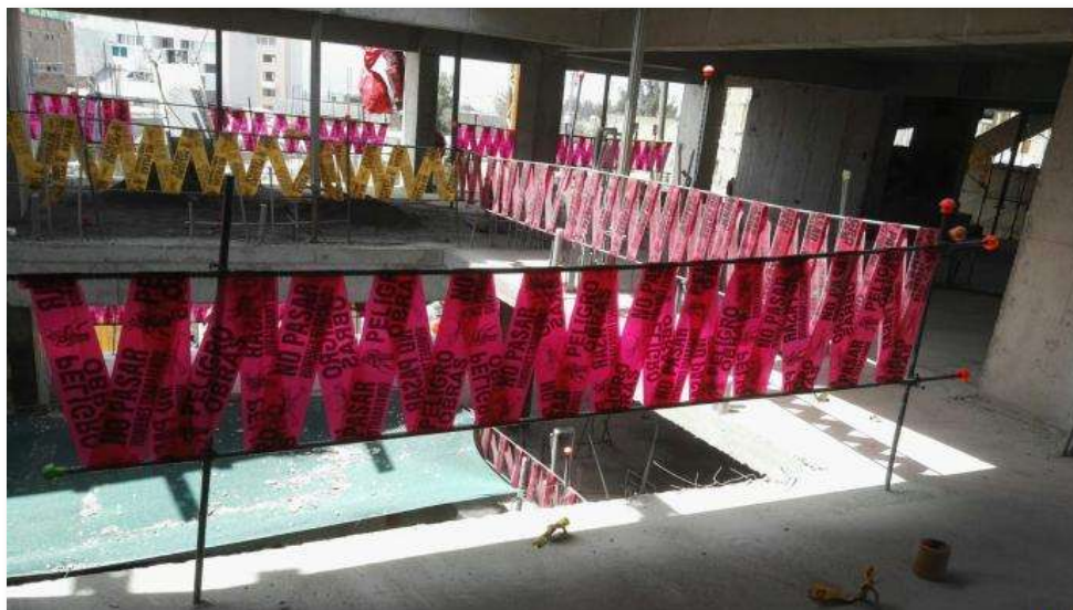
Figura 21: Cercado de zona con riesgo de caídas a distinto nivel. Fuente: Elaboración propia
