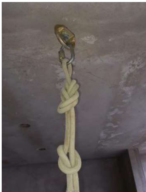
Figura 30: Punto de anclaje fijo
