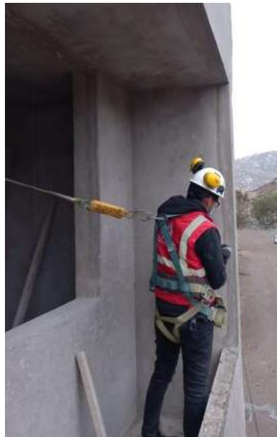
Figura 34: Trabajador con restricción a caída a distinto nivel Fuente: Elaboración propia
