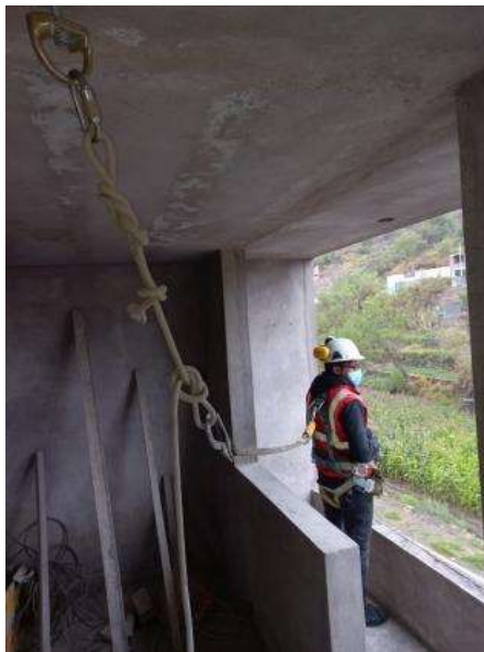
Figura 31: Punto de anclaje restrictivo sobre cabeza Fuente: Elaboración propia
