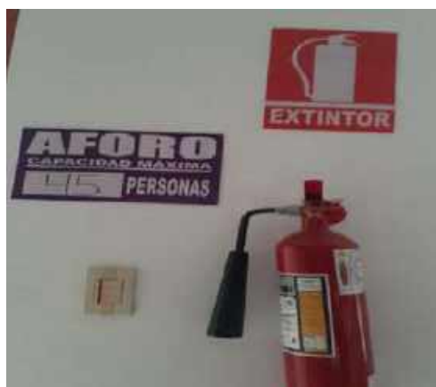
Figura 5-4: Ubicación de los Extintor portátiles en las diferentes áreas. Realizado por: Ramos Sandoval, María, 2020.
