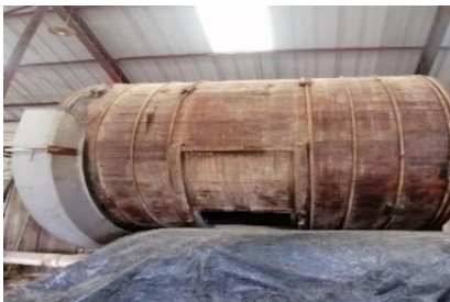
Figura 1-2. Bombo de pelambre y remojo
