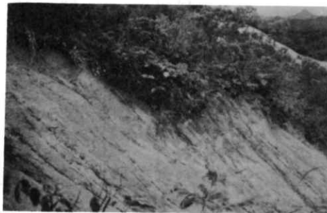
写真—3 表層滑落型の崩壊
