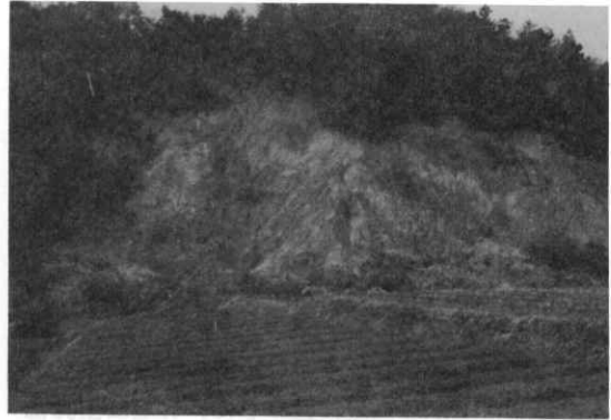
写真一六 傾斜変換部下方の急傾斜面の崩壊
