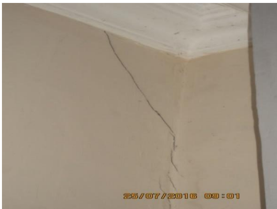
Gambar 2. Retakan di bidang dinding
