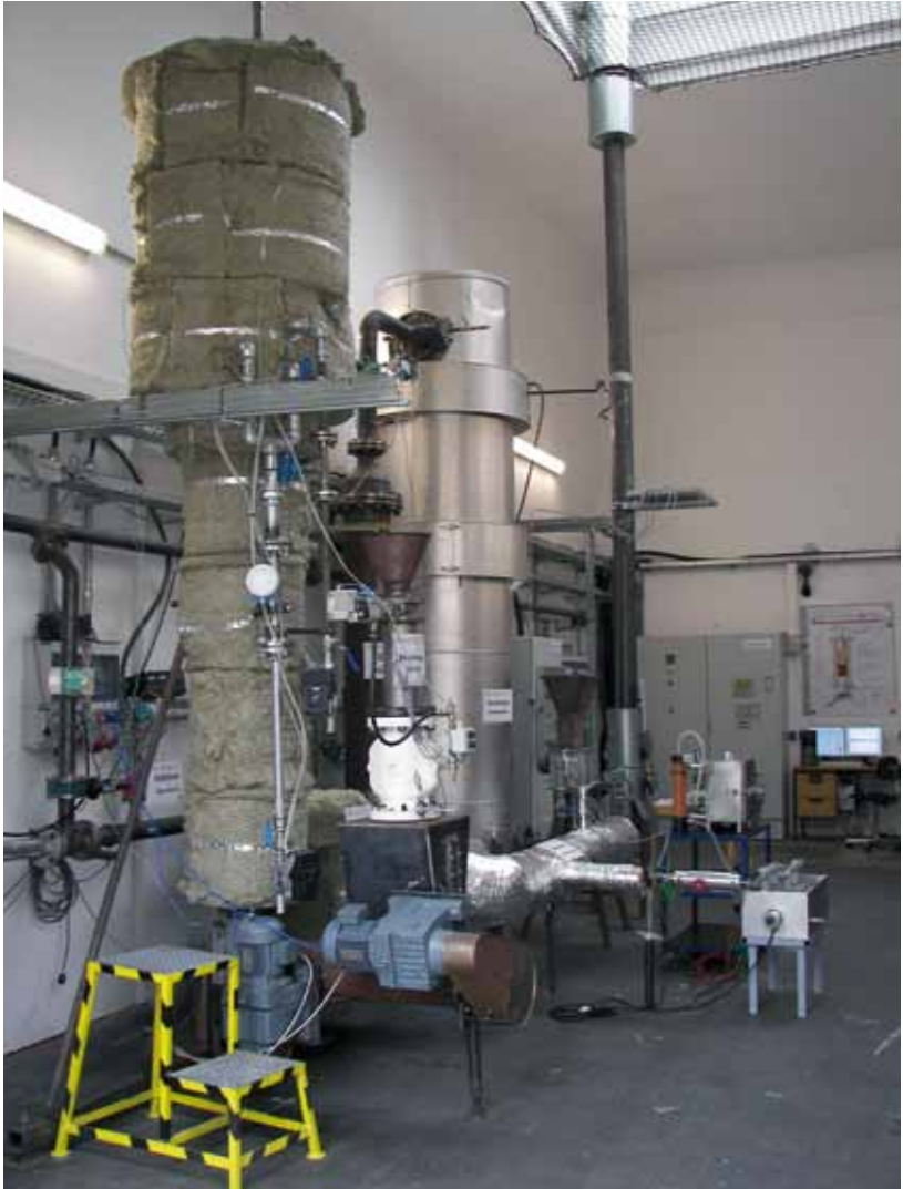
Abbildung 4.3 Ehemalige Vergasungsversuchsanlage der Stadtwerke Rosenheim. © Stadtwerke Rosenheim, Heigl (2014, S. 5).
