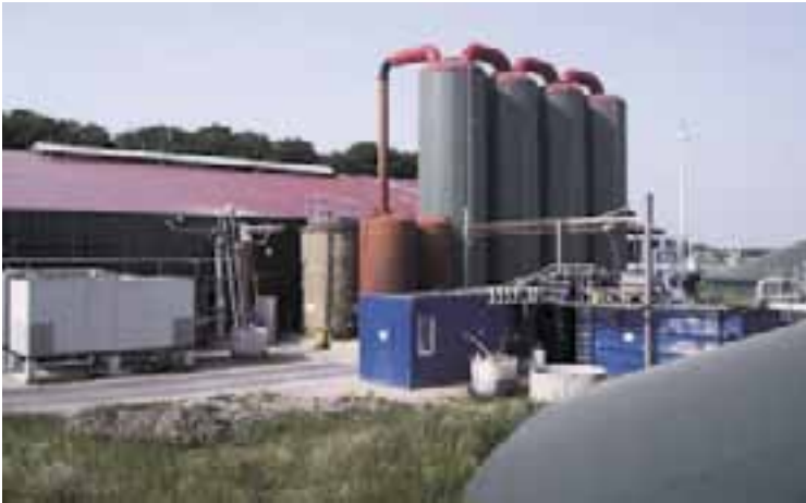
Abbildung 2: ANAStrip®-Anlage BENAS, Außenbereich.
