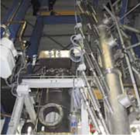
Abbildung 4: BioSyn-Vergasungsanlage im technischen Maßstab, ohne Isolierung.
