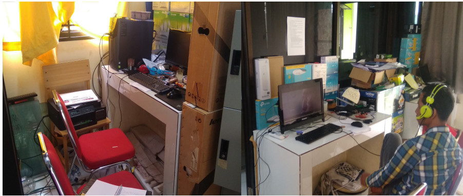
Gambar A.6. Ruang Kendali Server
