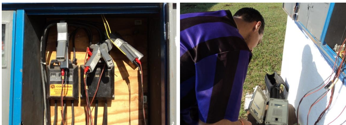
Figura 35. Instalação do medidor de grandezas elétricas para monitoramento da demanda na ETA em Cruzeiro.
