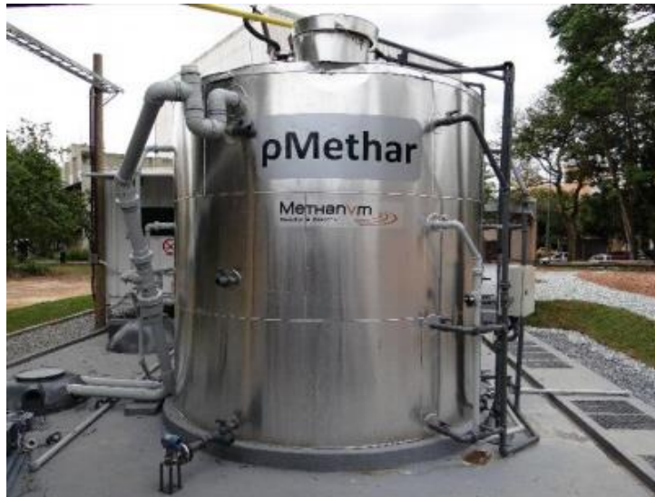
Figura 8: Digestor anaeróbico para a metanização de resíduos orgânicos na UFMG
