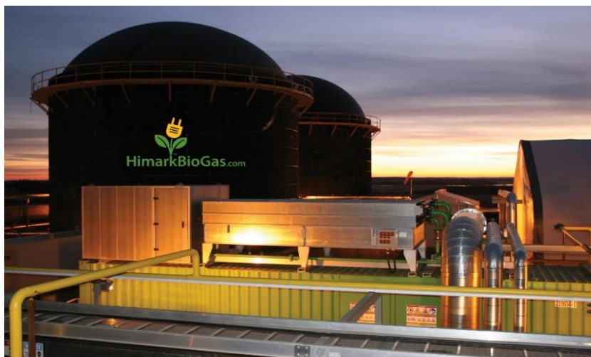
Figura 7: Plantas de digestores anaeróbios construídos na América do Norte.
