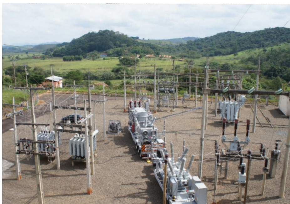
Figura 2.3 – Subestação móvel compacta em operação
