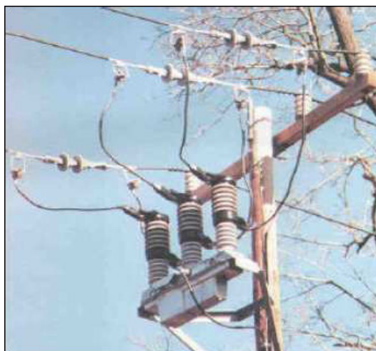
Figura 11 - Seccionador Automático Instalado [14].
