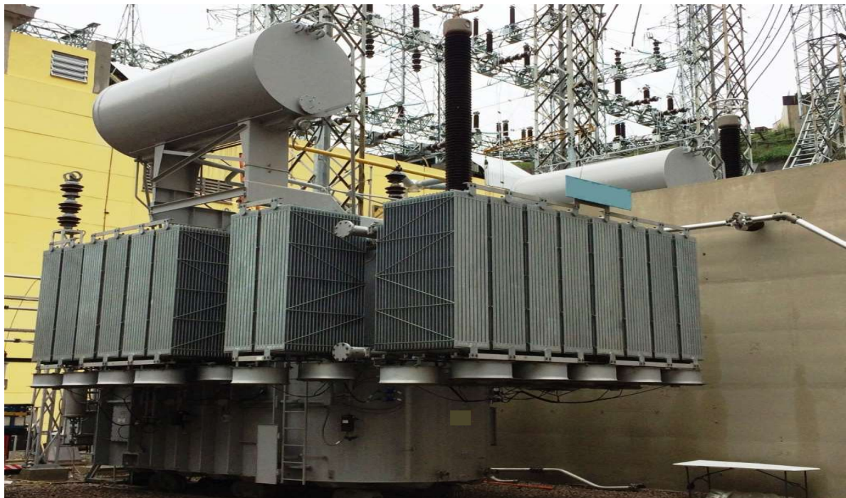
Figura 4.1 – Transformador de Potência Monofásico 200MVA, 500/\sqrt{3} / 138/\sqrt{3} / 13,8 (kV) instalado em uma subestação.
