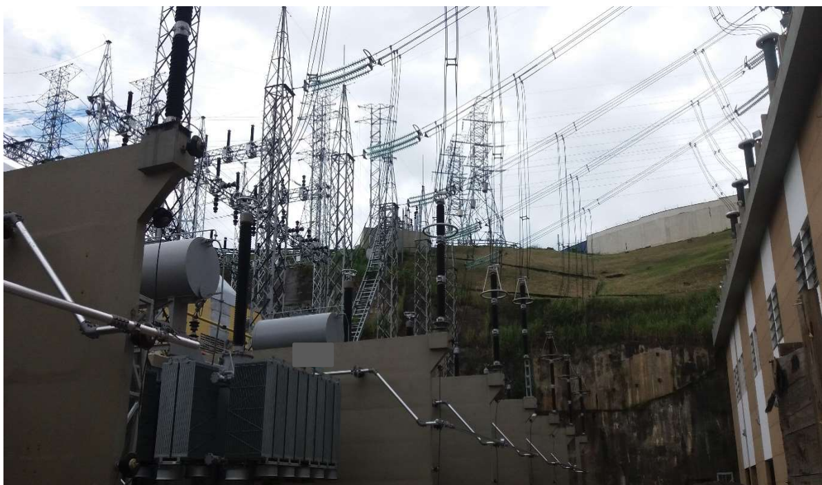
Figura 4.2 – Saída do prédio de 500 kV – Bancos de transformadores.
