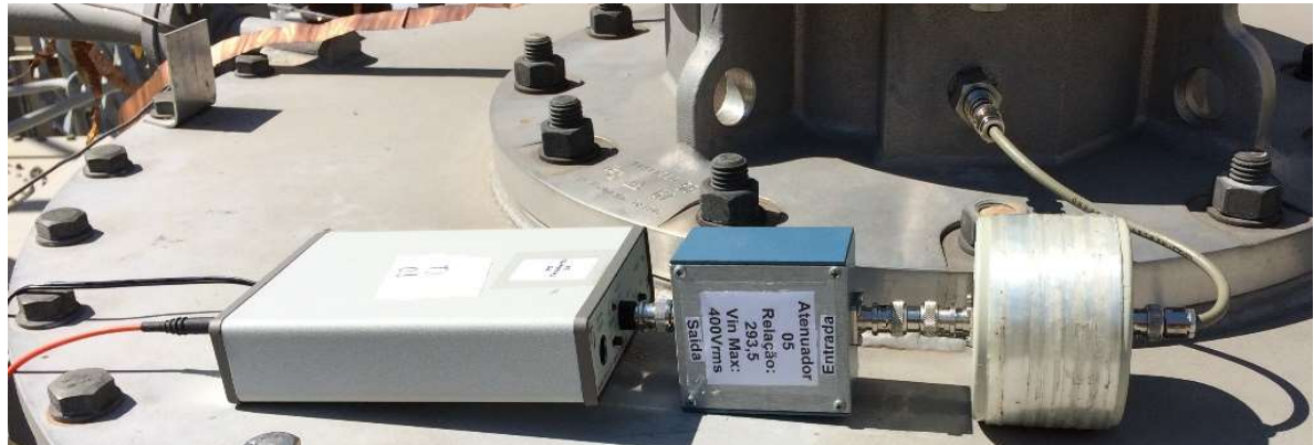
Figura 6.14 – Unidade secundária, atenuador e transmissor de fibra óptica conectados o tap capacitivo da bucha de alta tensão.
