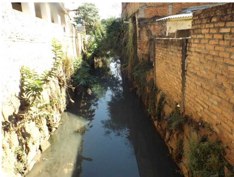
Figura 38: Áreas de Preservação Permanente do Ribeirão Lavapés, ocupadas por edificações. Fonte: Arquivo pessoal.
