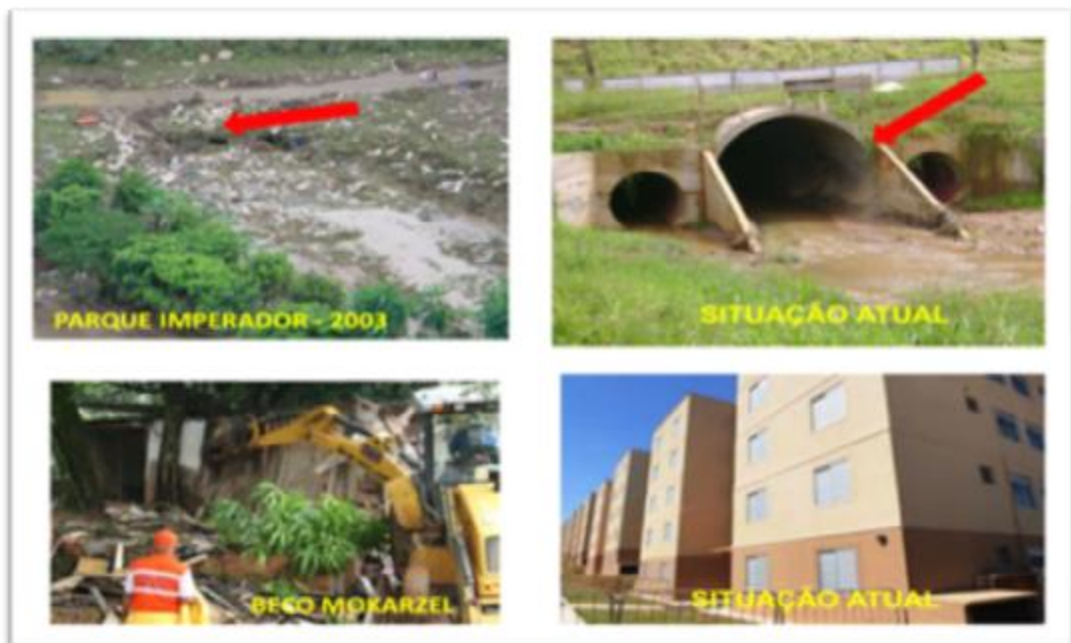
Figura 12. Recuperação das áreas degradadas em Campinas- SP. Fonte: Sidnei Furtado, ano 2013.
