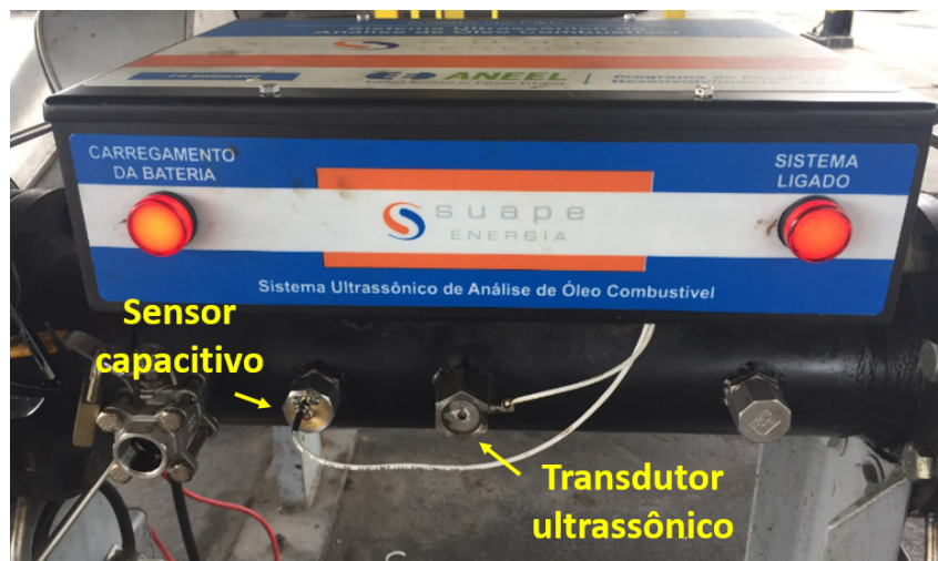
Figura 44 – Sensor capacitivo integrado ao protótipo em campo.
