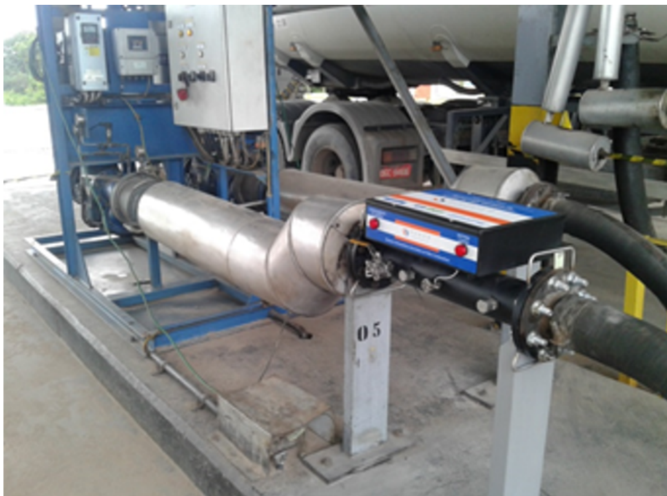
Figura 39 – Instalação em campo do protótipo em um dos terminais de abastecimento de óleo combustível.
