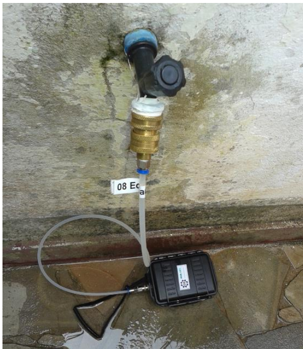
Figura 23 - Equipamentos etiquetados ( logger e mangueira) já instalados em campo.
