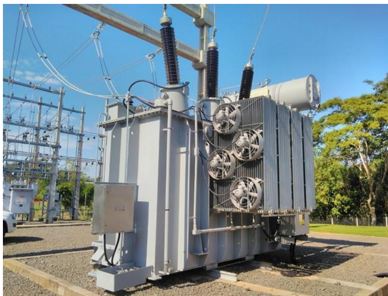
Figura 45 - Transformador monitorado na subestação Álvares Machado, fonte: foto do próprio autor
