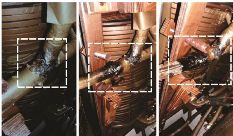
Figura 64 - Pontos de fragilidade do isolamento com formação de DPs, fonte: próprio autor
