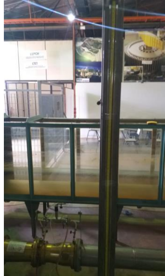
Figura 3.25: Manômetro em “U” do medidor de vazão tipo Venturi.
