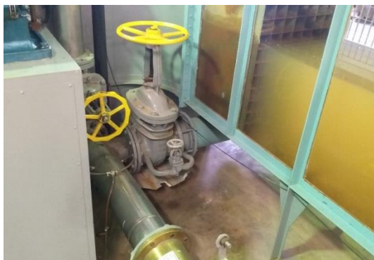
Figura 4B: Válvula pós acionamento da bomba, próxima ao Venturi.
