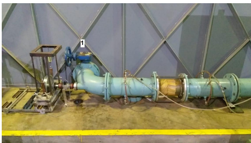
Figura 2B: Montagem do acrílico, rotor, distribuidor, torquímetro e gerador.
