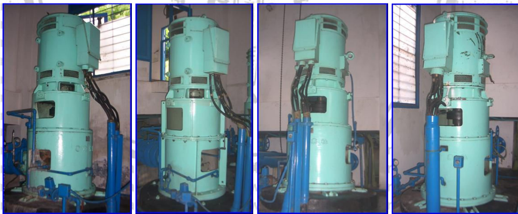
Gambar 5.4 Motor Pompa 1, 2, 3, dan 4 pada Rumah Pompa Wendit 1.
