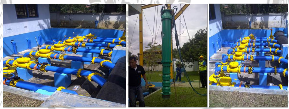
Gambar 5.8 Motor Pompa 1, 2, 3, 4, dan 5 dari Rumah Pompa Wendit 3. Sumber : PDAM Kota Malang, 2014.
