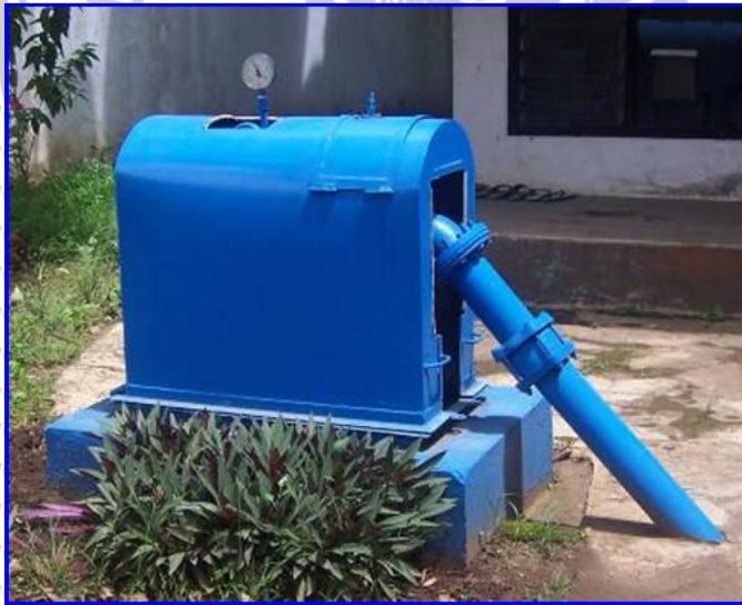
Gambar 5.14 Pompa pertama dari Rumah Pompa Badut.
