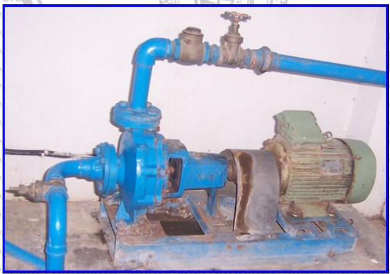
Gambar 5.17 Pompa dari Rumah Pompa Sumpersari. Sumber : PDAM Kota Malang, 2014.
