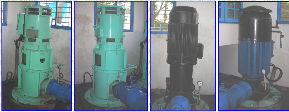
Gambar 5.6 Motor Pompa 1, 2, 3, dan 4 pada Rumah Pompa Wendit 2.
