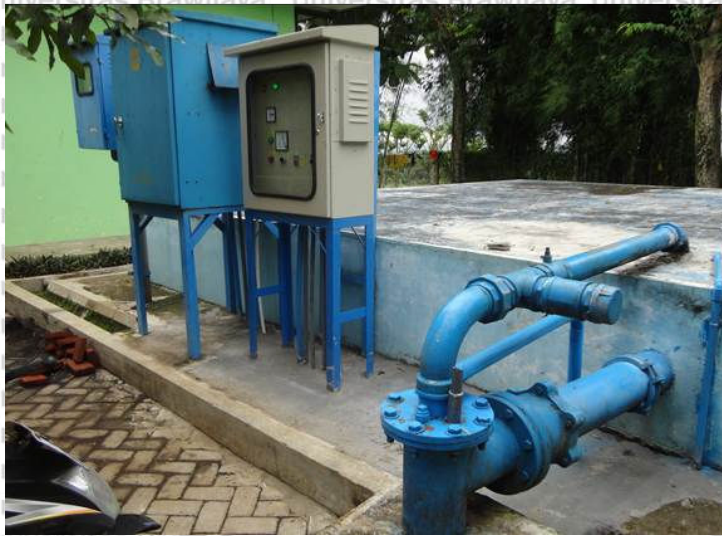
Gambar 5.21 Pompa dari Rumah Pompa Supit Urang. Sumber : PDAM Kota Malang, 2014.
