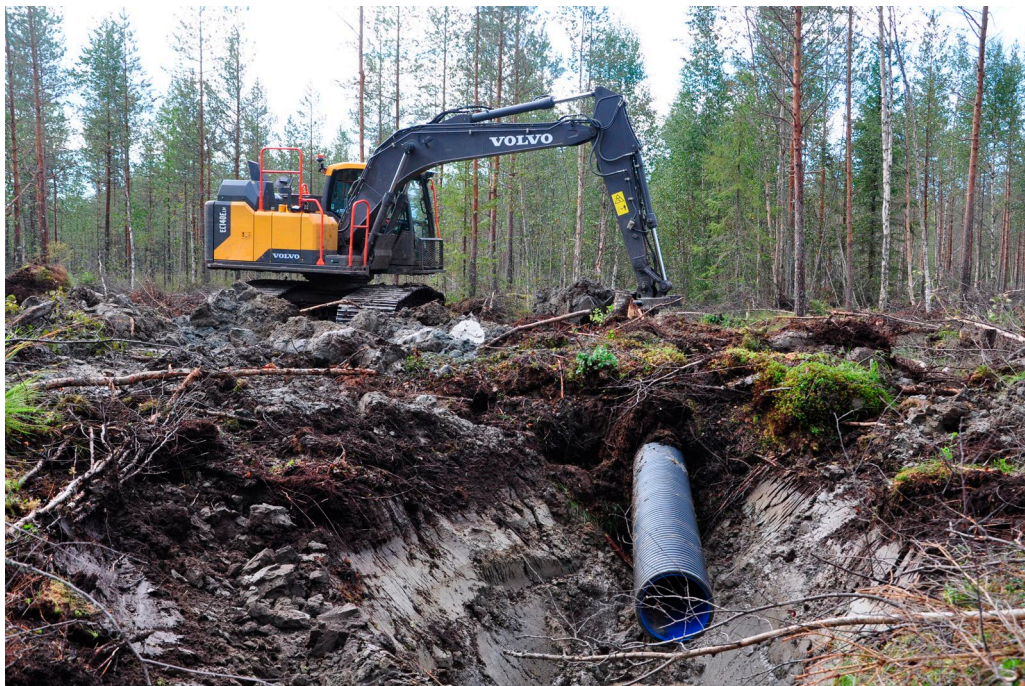
Kuva 9. TurVI-hankkeessa parannetaan turvemaiden ojituskäytäntöjä. Kuvassa on meneillään putkipadon ja laskeutusaltan yhdistelmän rakentaminen. Kuva: Jani Antila, Tapio Oy.
