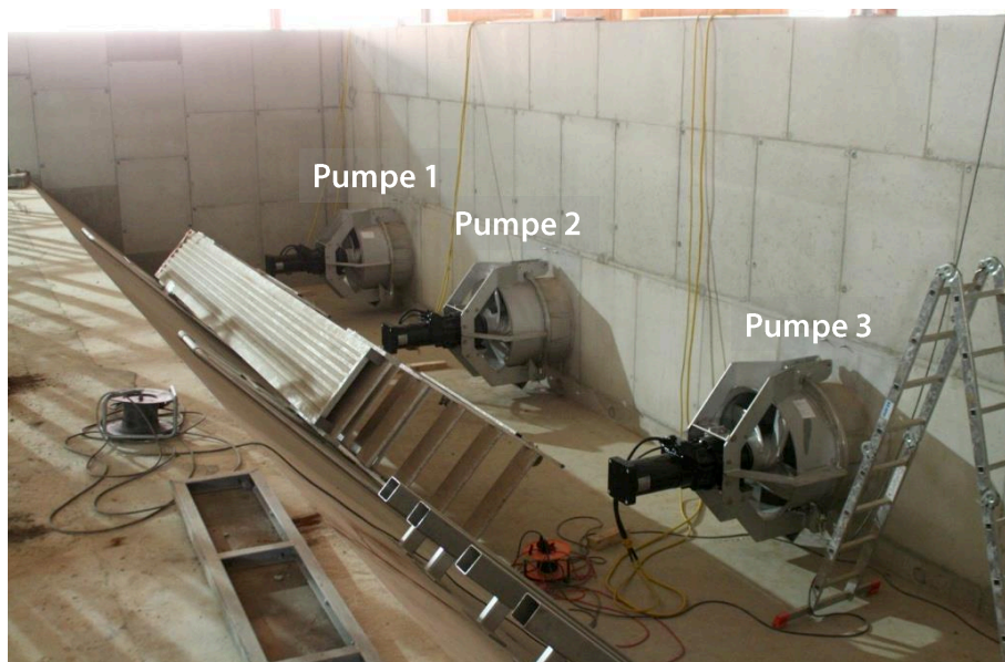
Abb. 3.7: Pumpensumpf der Strömungsanlage des 3D-Wellen-Strömungsbeckens
