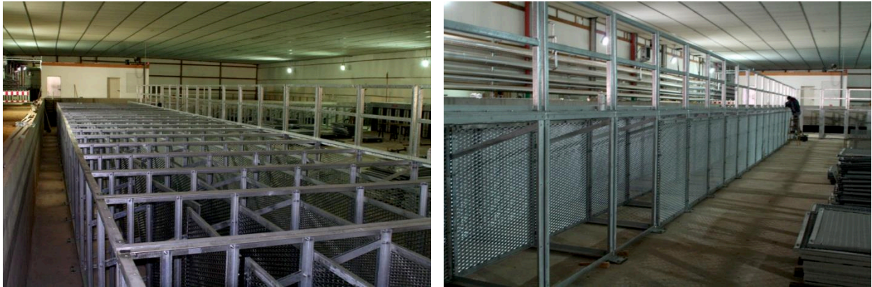
Abb. 3.9: links: rückseitige Ansicht der passiven Absorberelemente, vor der Montage der begehbare Gitterroste, rechts: vorderseitige Ansicht während der Montage.
