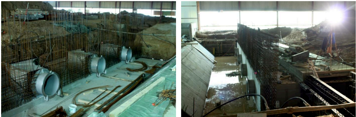
Abb. 3.6: Bewehrung um die Druckrohre im Bereich des Pumpensumpfes, Anschluss der Rezykulationspumpen und Übergang in den Rückführungskanal.
