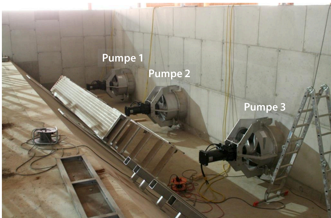
Abb. 4.5: Pumpensumpf der Strömungsanlage des 3D-Wellen-Strömungsbeckens
