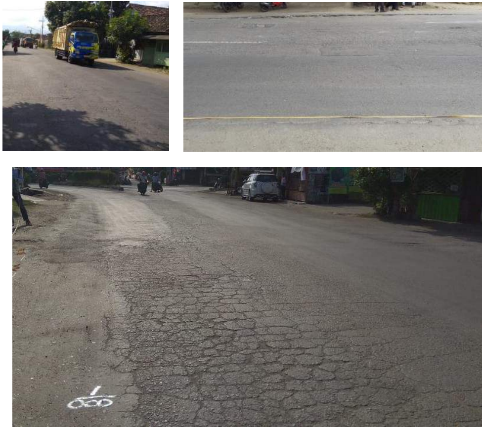
Gambar 1.1 Beberapa kerusakan retak buaya, retak memanjang dan amblas yang terjadi di Jln. Trunojoyo
