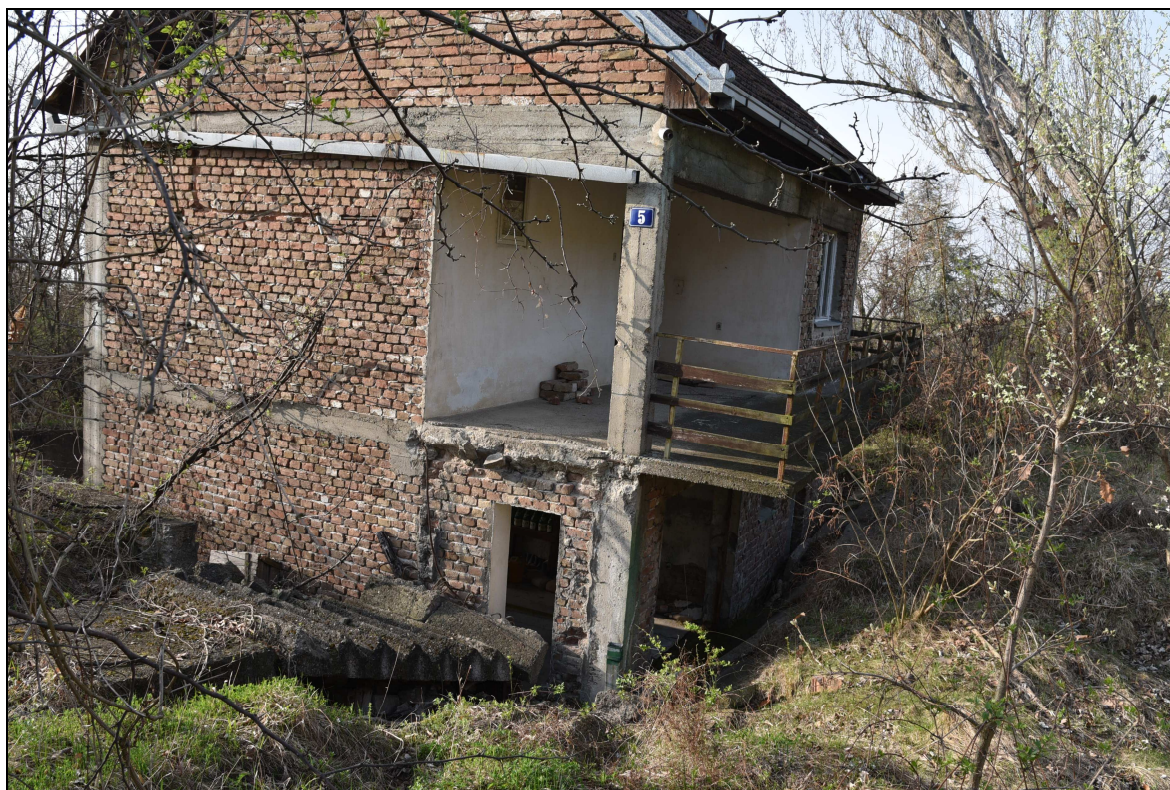
Слика 3.52. Оштећена и напуштена кућа на клизишту Умка (26_UMK)
