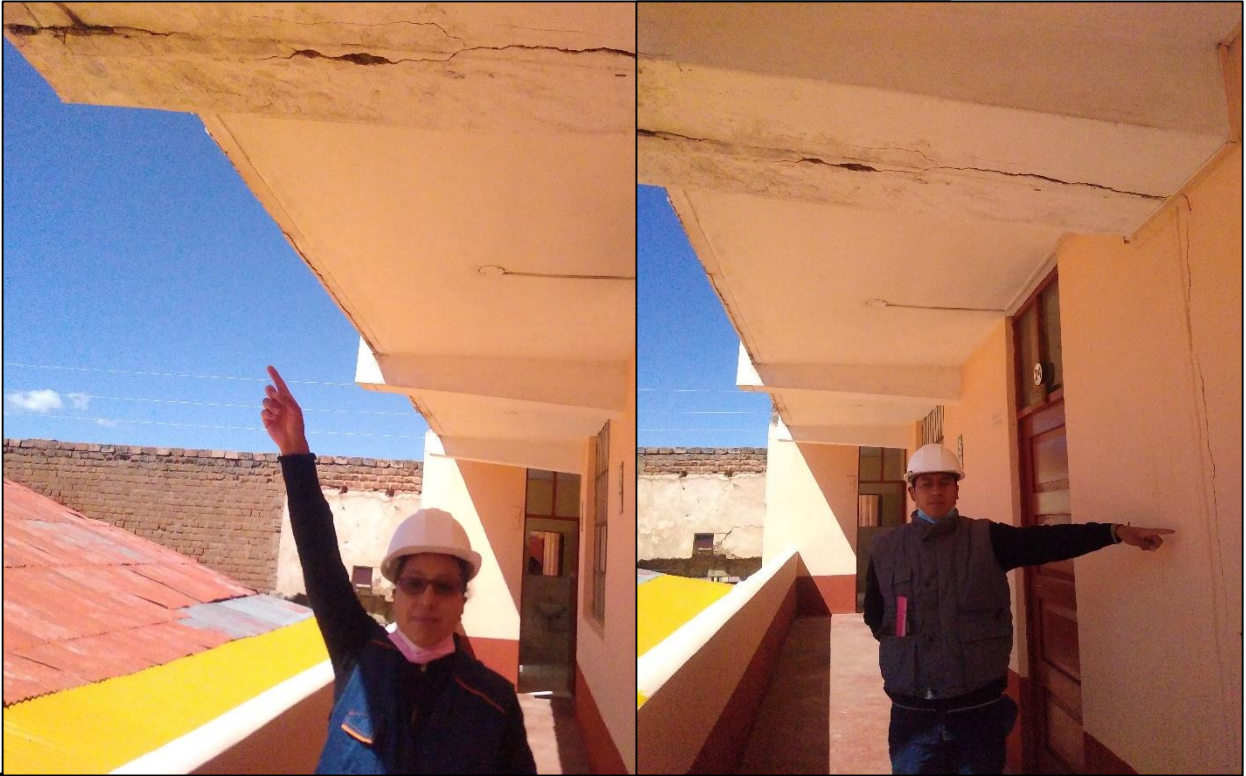
Fotografía señalando las fisuras que se pueden apreciar se encuentran tanto en vigas y columnas.
