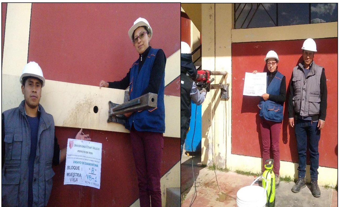
Fotografía realizando el ensayo la extracción de testigos de diamantina en columnas y vigas Losa de los distintos bloques.
