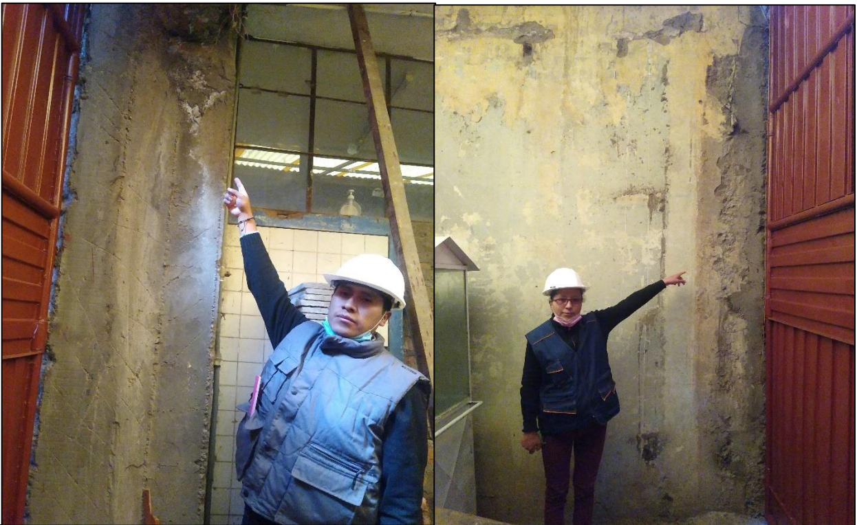
Fotografía señalando la humedad que se pueden apreciar en columnas.
