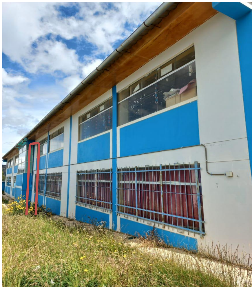
Figura 24. Junta sísmica no existente.
