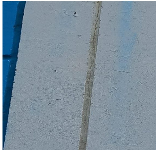
Figura 25. Rajadura en muros.
