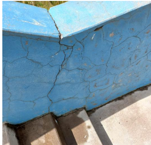
Figura 4. Fisura en parapeto de la I.E.S. Agropecuaria de Chocco
