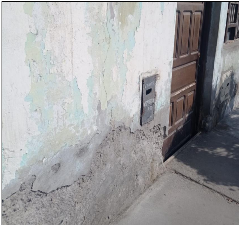
Foto 16. Mortero de tarrajeo dañado por humedad.
