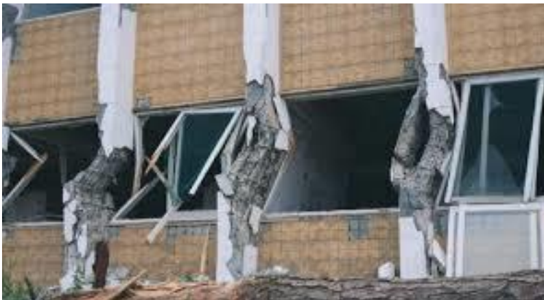
Figura 3: Falla por columna corta (Sismo de Pisco 2007) Fuente: (CENAIS, 2020)
