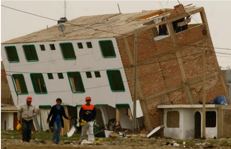
Figura 5: Piso blando y torsión (Sismo Pisco 2007)
