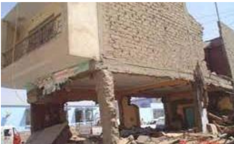
Figura 4: Discontinuidad vertical de elementos portantes (Sismo Pisco 2007) Fuente: blog.pucp.edu.pe/blog
