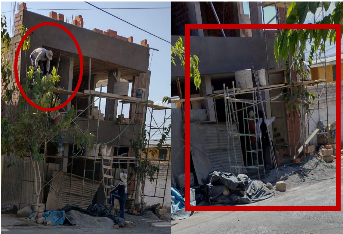
Figura 4. Evidencia de inadecuadas condiciones de trabajo y exposición del trabajador
