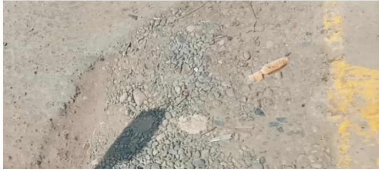
Figura 33. Área del pavimento asfáltico con hundimiento.
