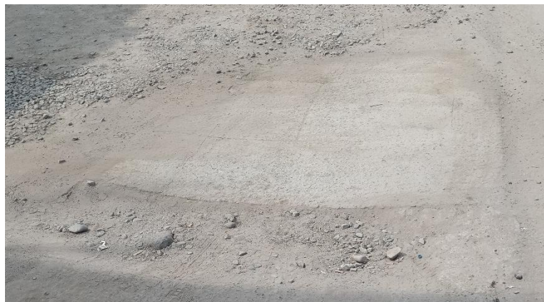
Figura 34. Área del pavimento asfáltico con parcheo.
