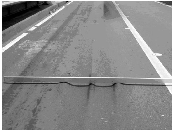
Figura 1. Daño por ahuellamiento
