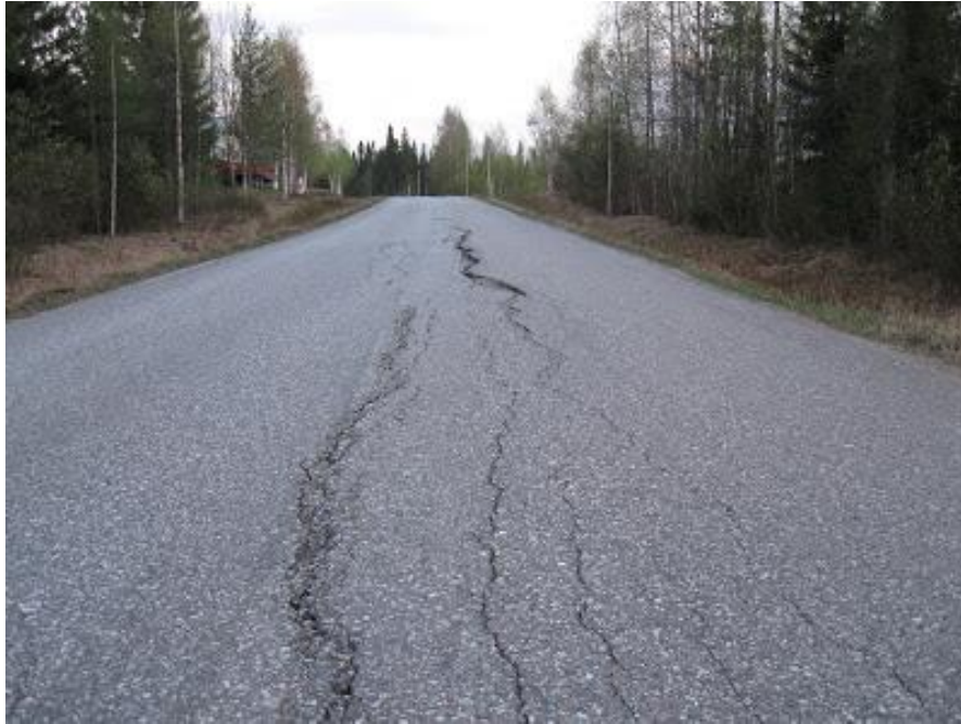
Figura 2. Falla de fisura longitudinal
